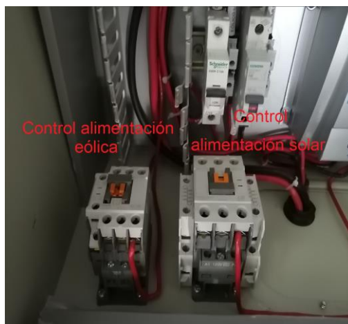
Fig. 5. Implementación de contactores para el control del sistema eólico - solar.
