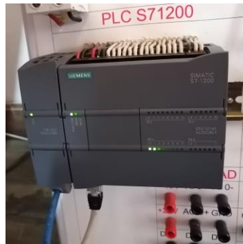
Fig. 72. Prueba de funcionamiento del PLC.
