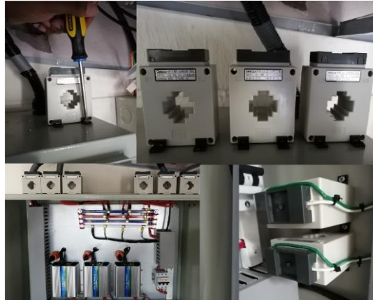
Fig. 59. Instalación de TC's en el tablero de inversores.
