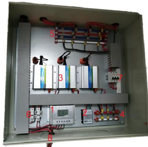
Fig. 57. Tablero de inversores.
