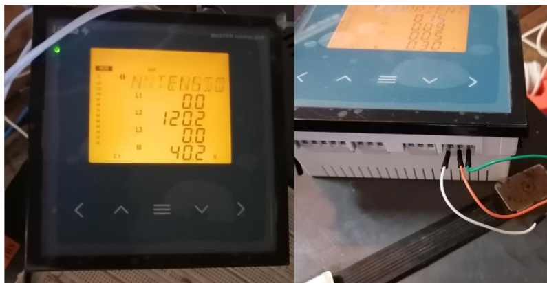
Fig. 71. Prueba de funcionamiento de analizadores.
