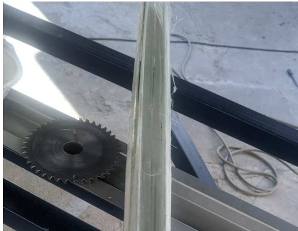
Figura 35: Prueba 2- Perfil frágil que muestra partes que no se compactan correctamente
