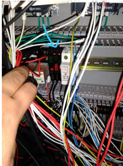
Figura 41: Cables excesivos dentro del tablero de control
