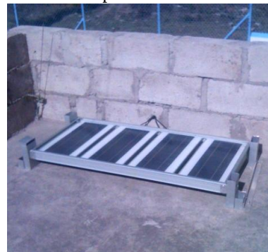
Fig 12 Paneles fotovoltaicos instalados sobre el techo
