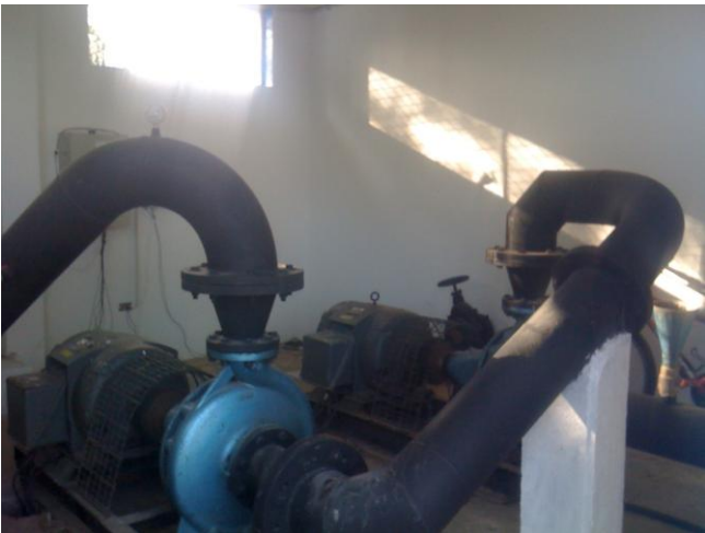
Fig 4 Grupos motor – bomba estación dos
