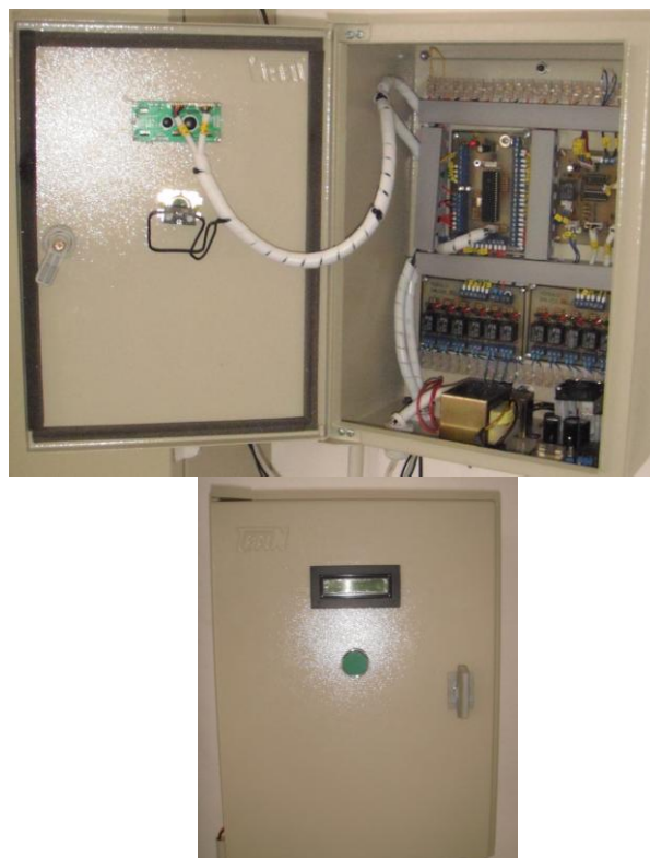
Fig 11 Tablero industrial Estación dos
