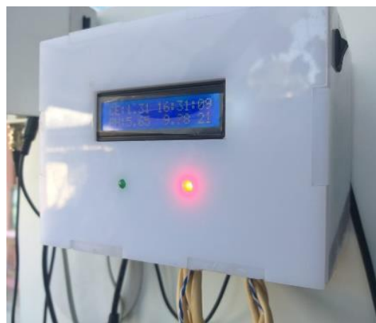
Figura 19. Caja de control del sistema de riego y dosificación.
