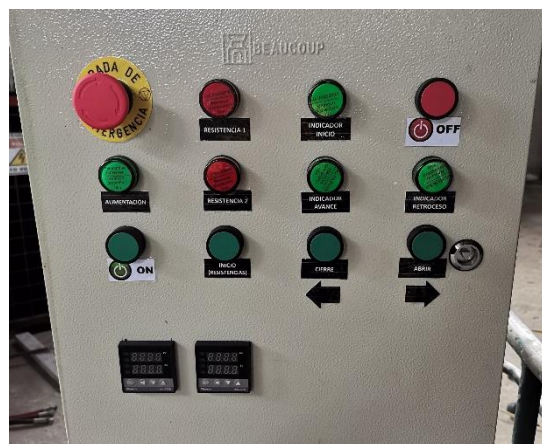
Figura 29: Tablero de control.
