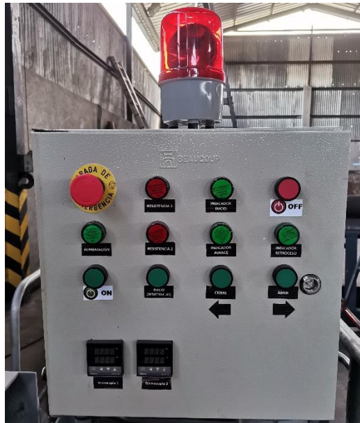
Figura 40. Tablero de control terminado.
