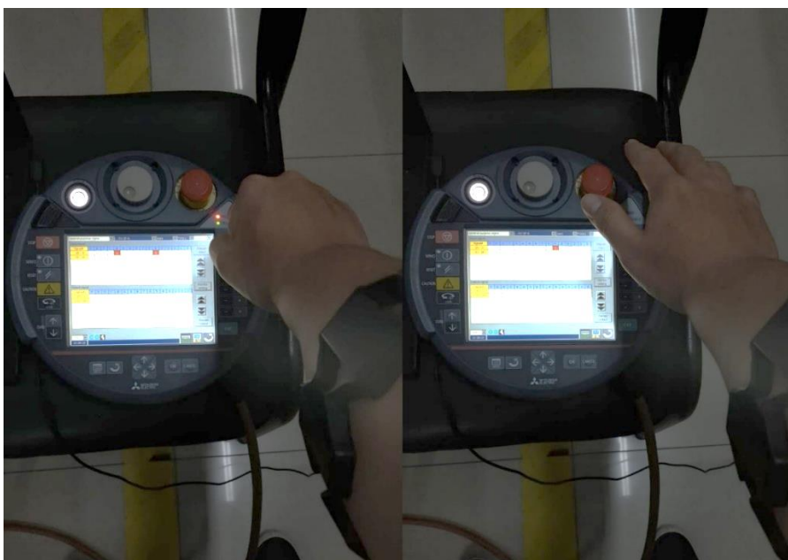
Figura 44: Prueba de activación de entrada del controlador.
