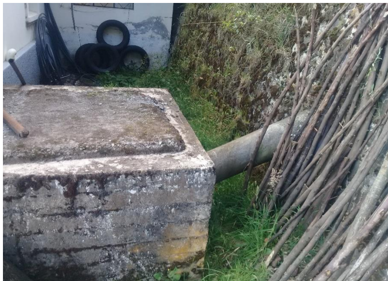
Fig. 35 Tubería forzada Fuente: Propia
