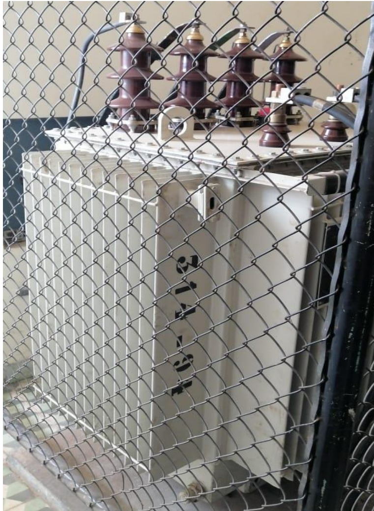
Fig. 44 Transformador trifásico Fuente: Propia
