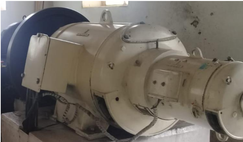
Fig. 43 Generador Fuente: Propia
