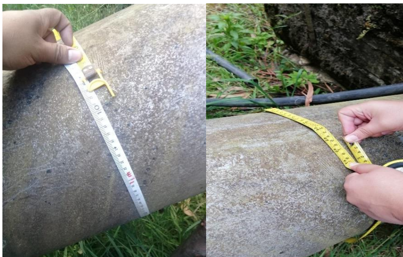
Fig. 41 Perímetro de la tubería forzada Fuente: Autor.
