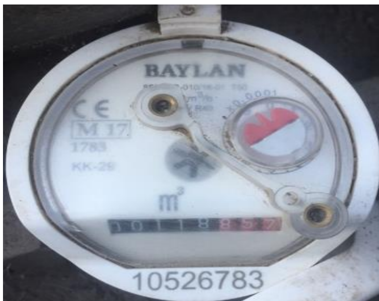
Figura 23. Medidor de Agua potable, que ha sido instalado en los domicilios de los usuarios
