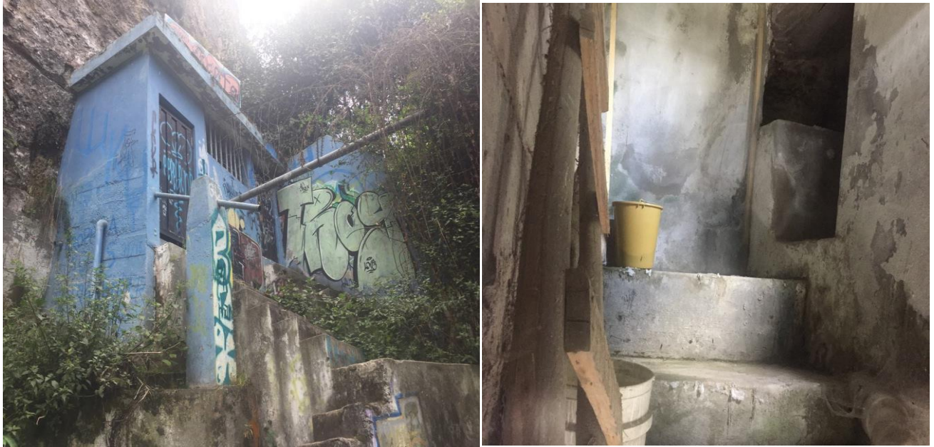
Figura 62. Estructura de captación del agua
