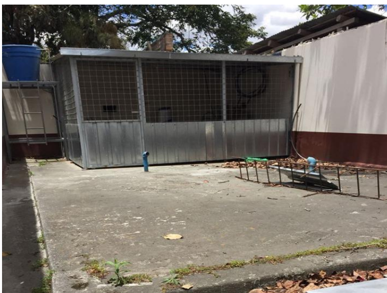
Figura 21. Instalaciones del tanque reservorio de agua
