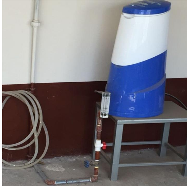
Figura 22. Sistema de cloración de agua PULSAR SYSTEM 1
