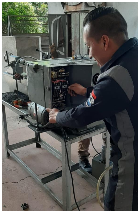
Figura A.I.2 Revisión del sistema eléctrico
