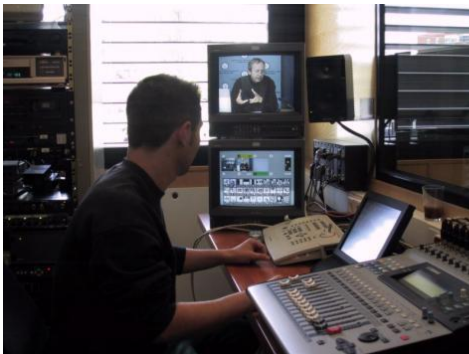
Fig. D-3: Disposición de los equipos en la cabina de control
