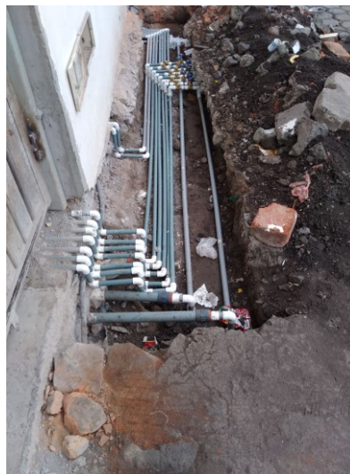
Fig. 15 Tuberías de distribución de agua potable
