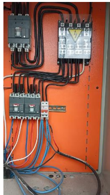
Fig. 2.13. Subtablero de distribución del área del reservorio y oficinas
