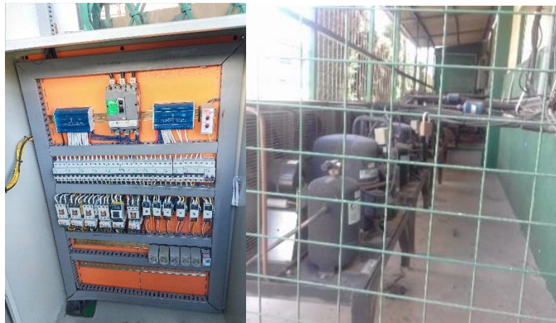
Fig. 2.16. Tablero de control, grupo 1 de unidades condensadoras. Fuente: el autor.
