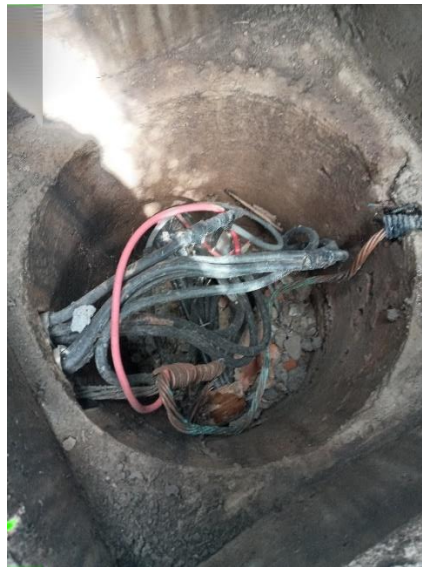
Fig. 2.9. Sistema de puesta para los equipos de unidades condensadoras y poscosecha de Bella Rosa. Fuente: el autor
