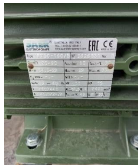
Fig. 2.12. Placa de bomba centrífuga Saer del reservorio de la Zona 1 alta. Fuente: el autor
