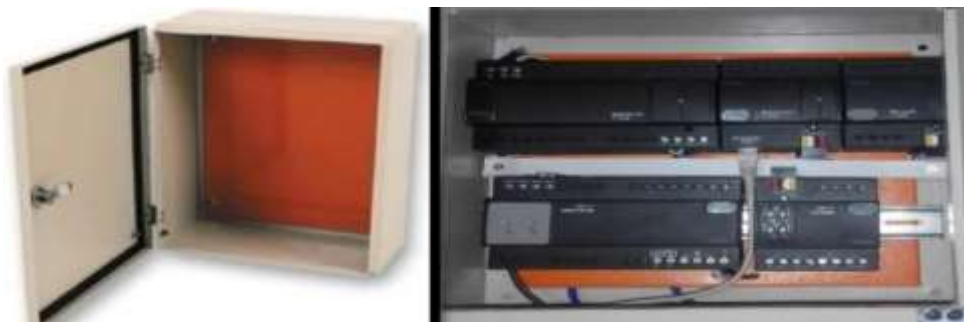
Fig. 49: Gabinete de los equipos HDL. Fuente: Autor
