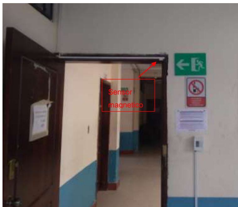
Fig. 57: Sensor magnético instalado. Fuente: Autor.
