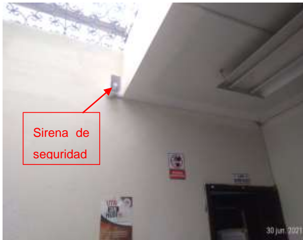
Fig. 58: Sirena de seguridad instalada. Fuente: Autor.
