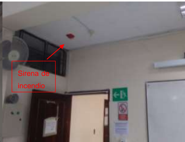
Fig. 59: Sirena de incendios instalada. Fuente: Autor.
