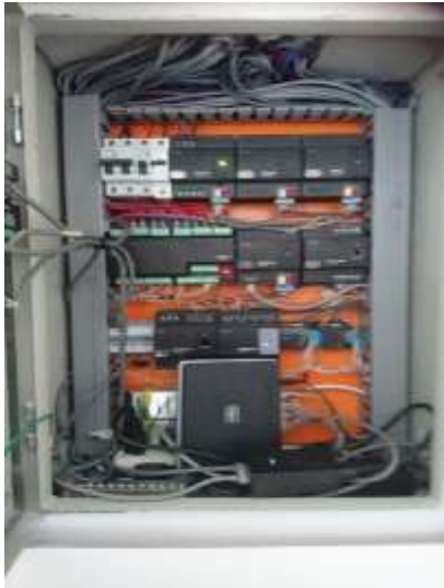
Fig. 13. Tablero de control Luxury Home. Fuente: (HDL Ecuador, 2018)
