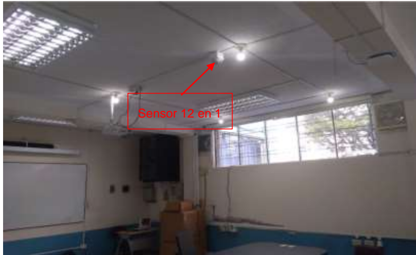
Fig. 52: Sensor 12 en 1 instalado. Fuente: Autor.
