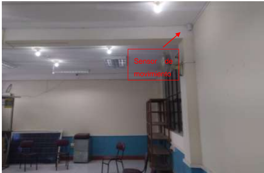
Fig. 56: Sensor de movimiento infrarrojo instalado. Fuente: Autor.
