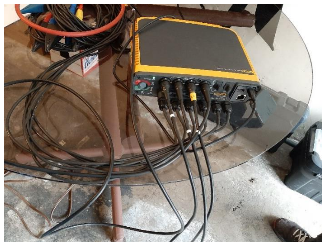
Figura 2.11 Analizador de energía
