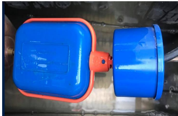
Fig.44. Interruptor de nivel. Fuente: (Autor,2021)
