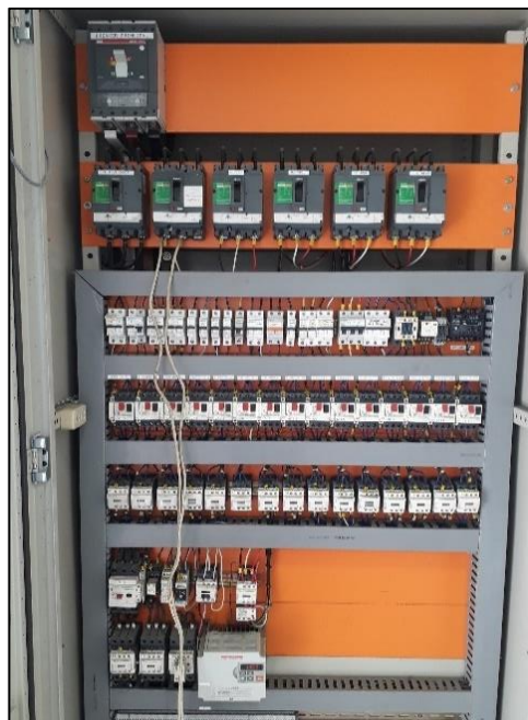
Fig. 63. Tablero secundario transformador 2. Fuente: El autor.
