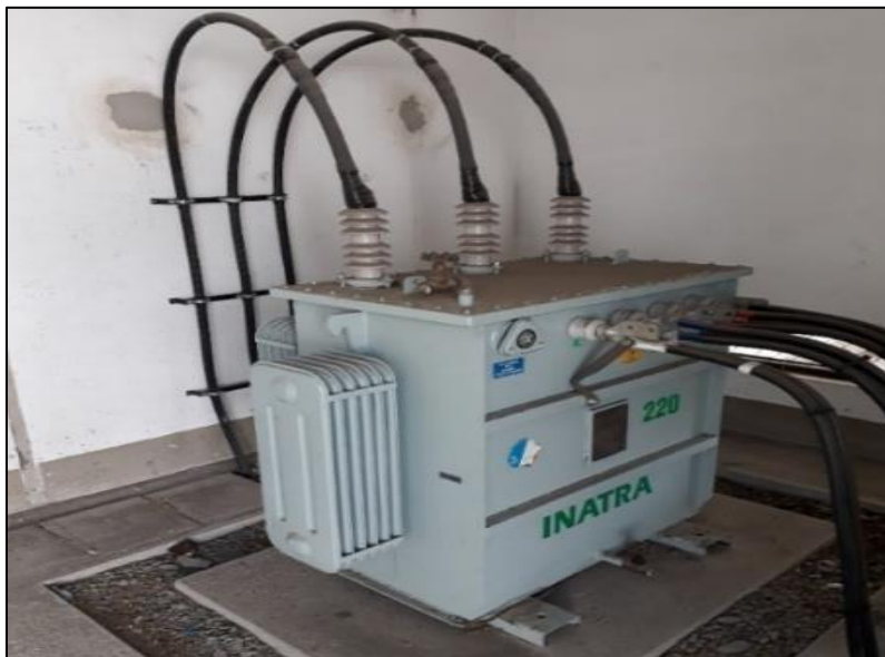
Fig. 17. Transformador N°1 de 220 KVA. Fuente: El autor
