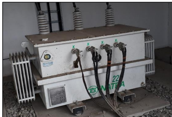
Fig. 20. Transformador 4 de 225 KVA. Fuente: El autor.
