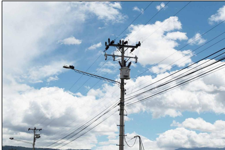
Fig. 16. Transformador de medición de voltaje y corriente. Fuente: El autor.
