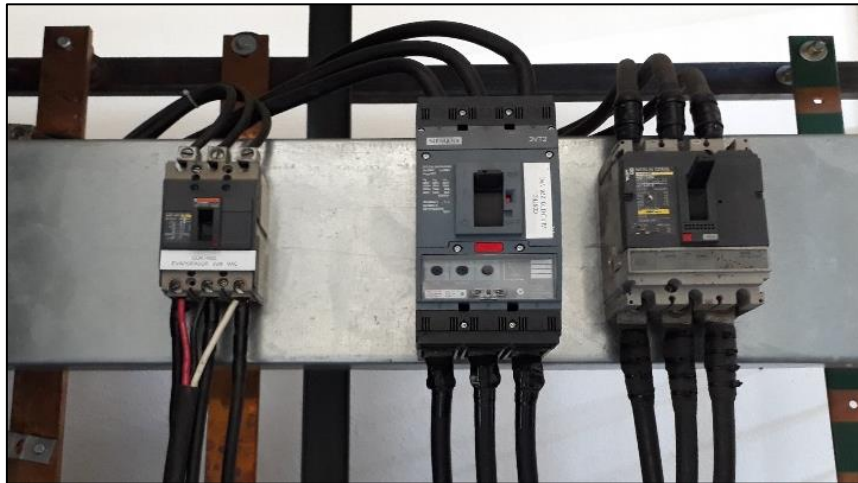
Fig. 62. Tablero principal transformador 2. Fuente: El autor.
