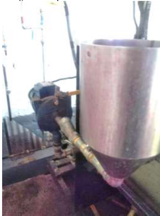
Motor-bomba auxiliar de ingreso de químicos
