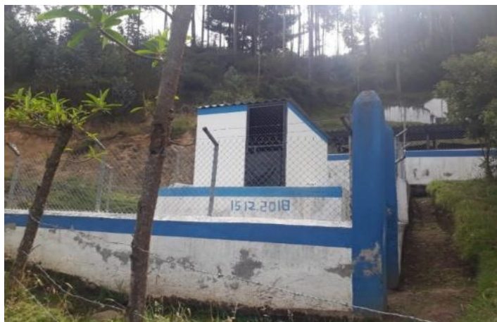
Figura 7. Planta potabilizadora de Angochagua
