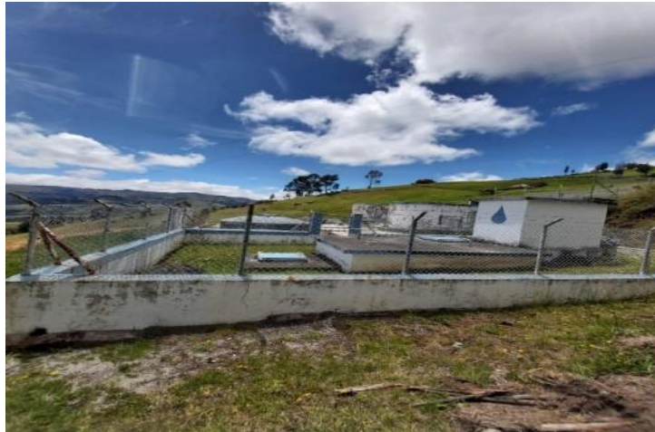
Figura 11. Planta potabilizadora de Cochas
