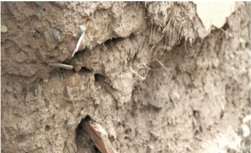
Figura 35. Muro de adobe y detalle del enlucido dañado, 2017.
