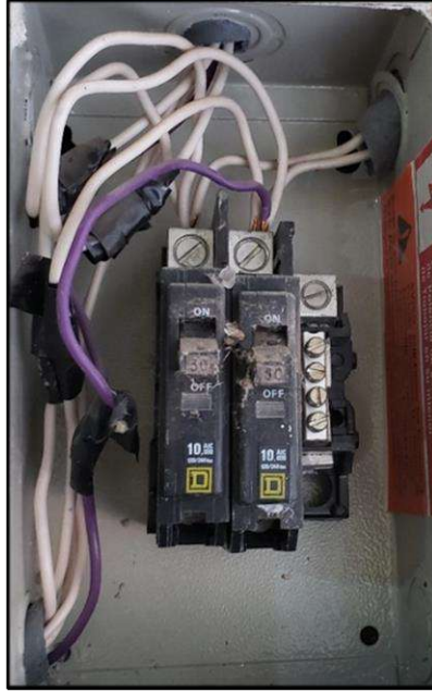
Figura. 41: Tablero de distribución fuera de servicio de la oficina 5
