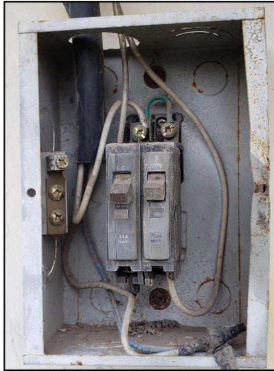
Figura. 33: Sub tablero de distribución 3
