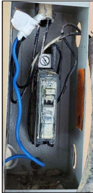
Figura. 35: Protección termomagnética individual 2
