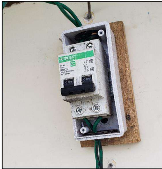
Figura. 36: Protección termomagnética individual 3
