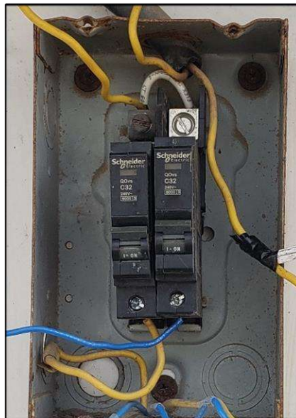
Figura. 29: Sub tablero de distribución 1
