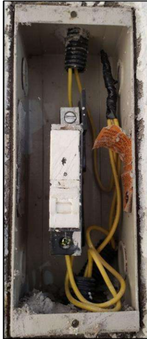
Figura. 34: Protección termomagnética individual 1
