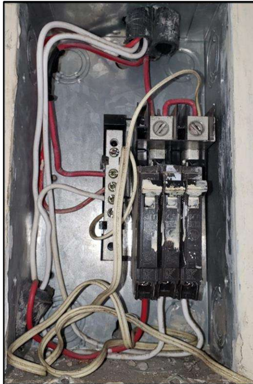
Figura. 40: Tablero de distribución 5
