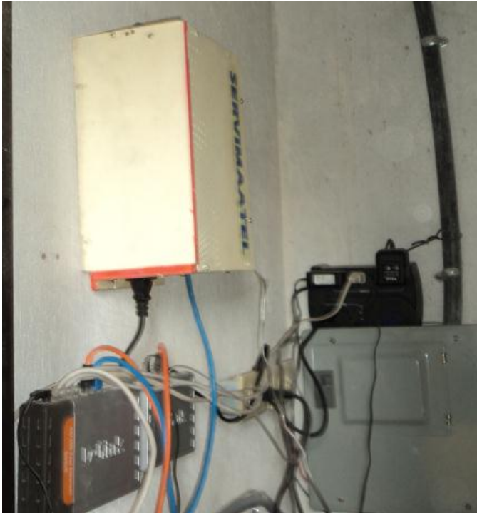
Figura 9. Implementación de la central de videotelefonía en la “MLE”
