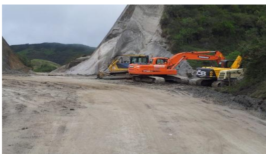
Vías en malas condiciones
