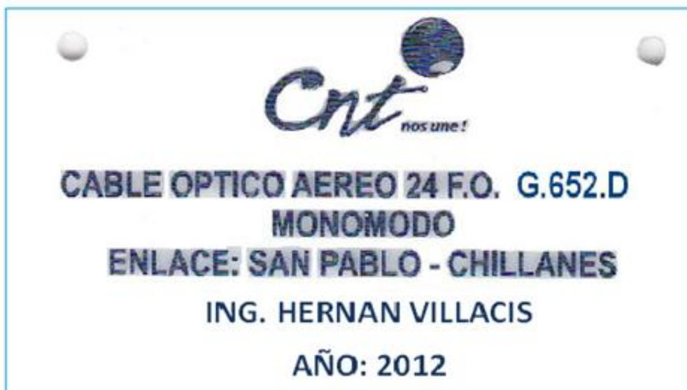
Figura 20.1 Identificador acrílico del enlace de Fibra Óptica.
