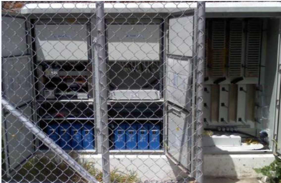
Figura 8. MSAN instalado en el centro poblado de Yahuarcocha.
