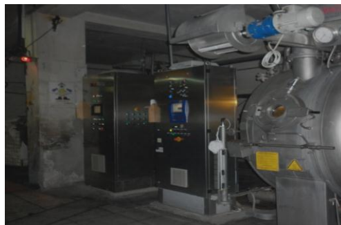
Figura N° 8 Tinturadora BRAZZOLI, Indutexma
