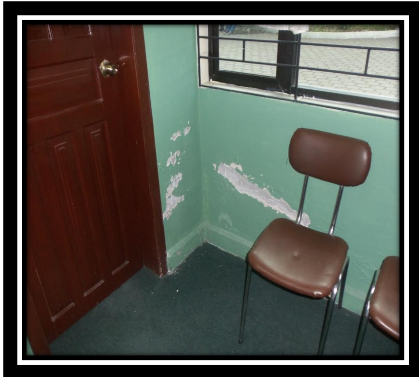
PRESENCIA DE HONGOS, HUMEDAD
