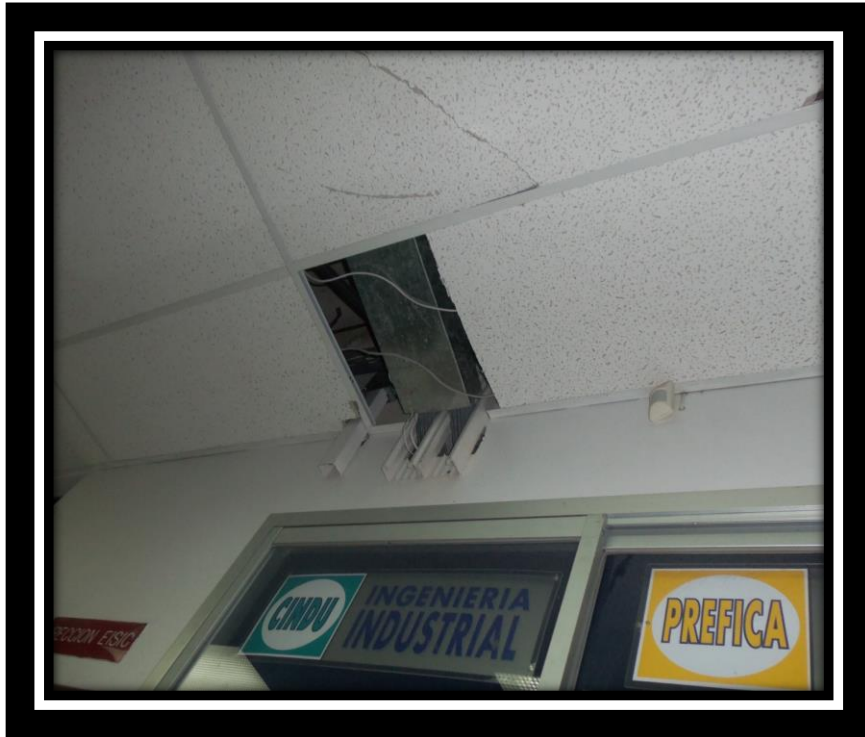
MAL ESTADO DEL EDIFICIO, CAÍDAS DE OBJETOS, RIESGO ELÉCTRICO
