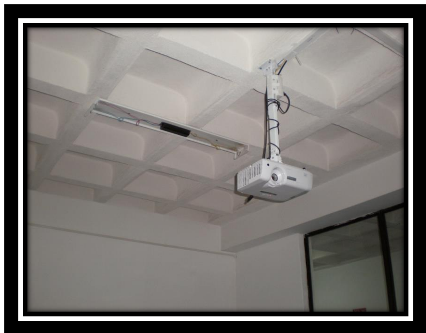
ILUMINACIÓN INSUFICIENTE, MALAS INSTALACIONES ELÉCTRICAS, CAÍDAS DE OBJETOS
