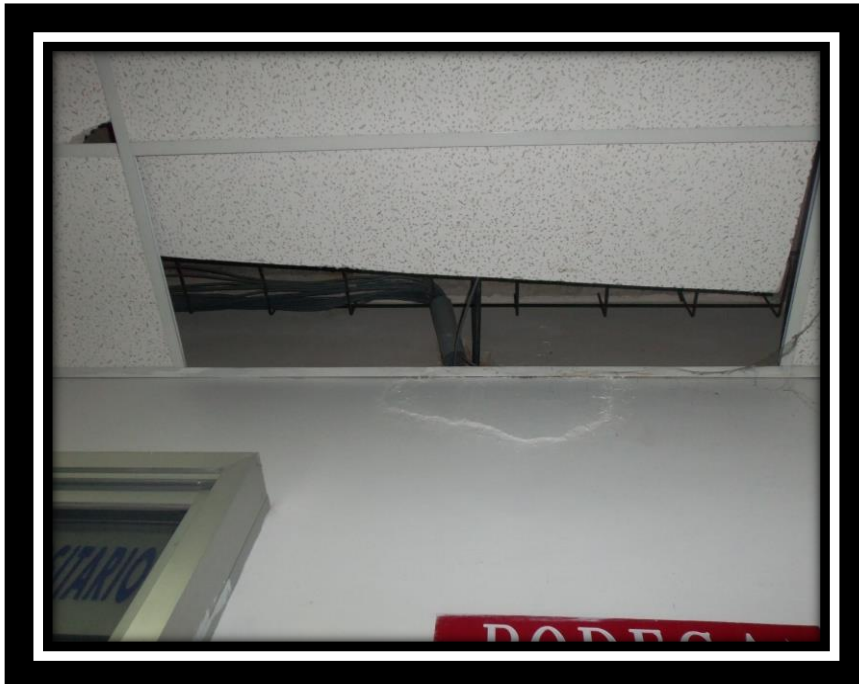
MAL ESTADO DEL EDIFICIO, CAÍDAS DE OBJETOS, RIESGO ELÉCTRICO
