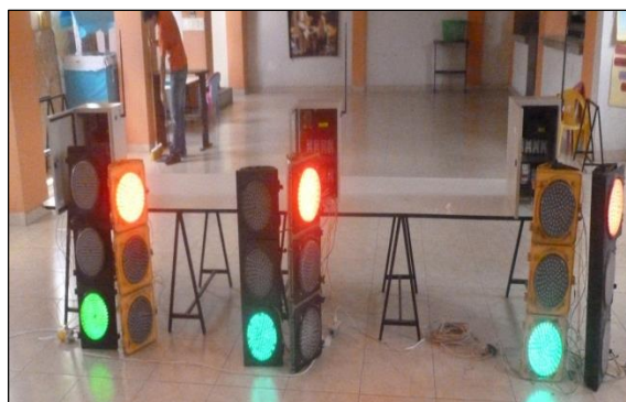
Figura 15. Sistema de Semaforización trabajando en modo Normal
