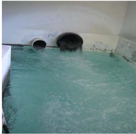
Fotografía 1 Recepción Agua Cruda
