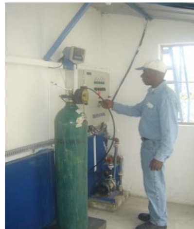
Fotografía 5 Equipo de Cloración
