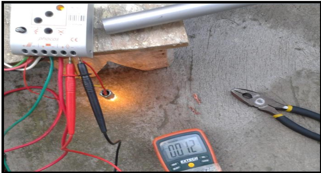
Figura N° 55: Medición de voltaje de operación del sistema
