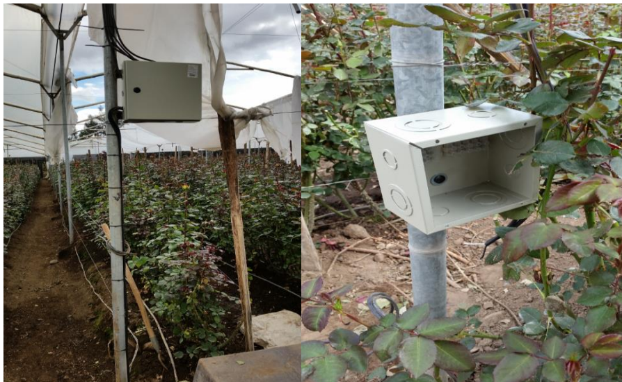
Figura 72: Cajas de distribución ubicadas en los invernaderos
