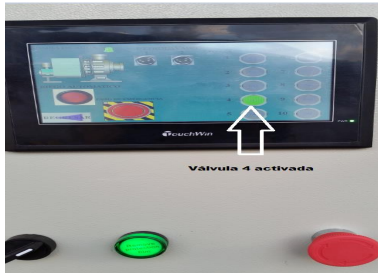
Figura 78: Activación de la válvula 4 en el riego por goteo
