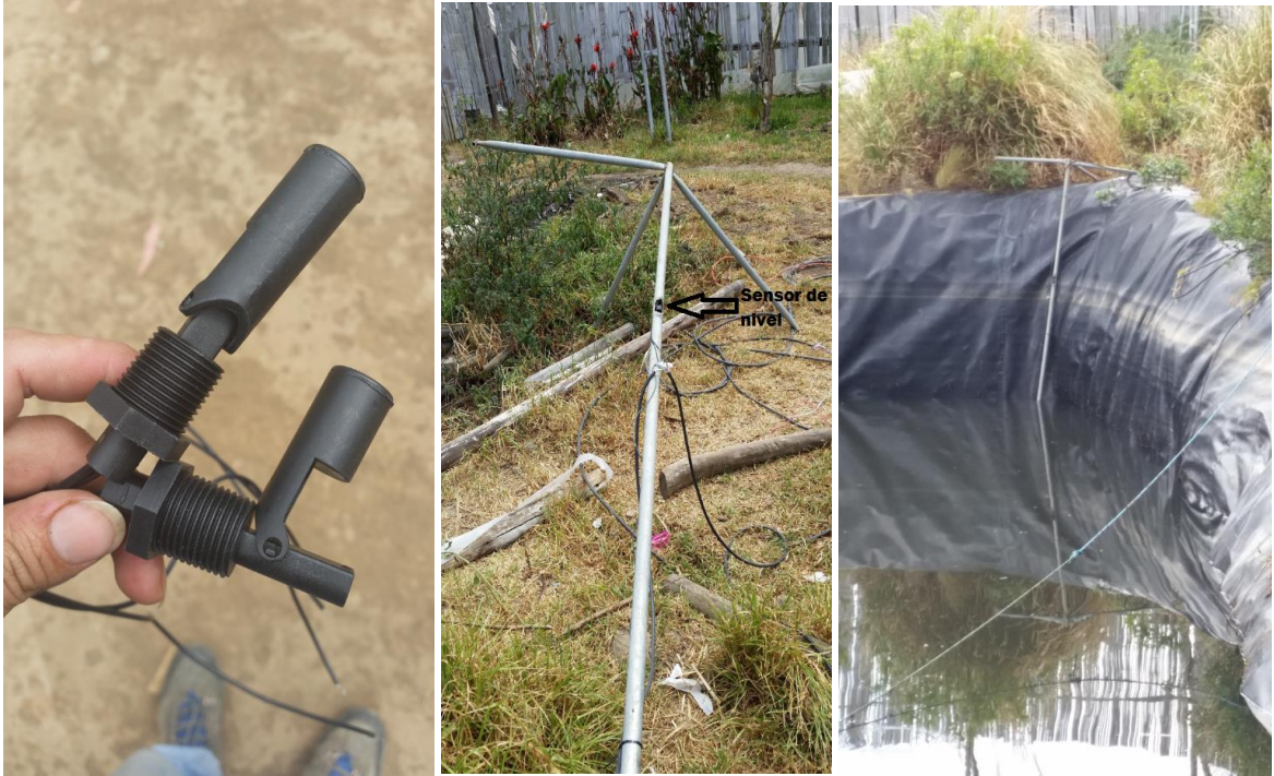
Figura 75: Sensores para el reservorio
