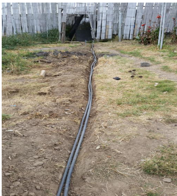
Figura 67: Línea eléctrica principal que va desde el cuarto de bombas hacia los invernaderos
