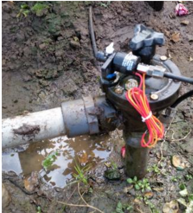
Figura 71: Solenoide ya instalado
