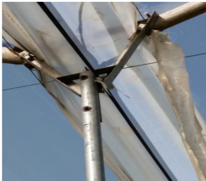
Figura 64: Cable pasado por los postes del invernadero
