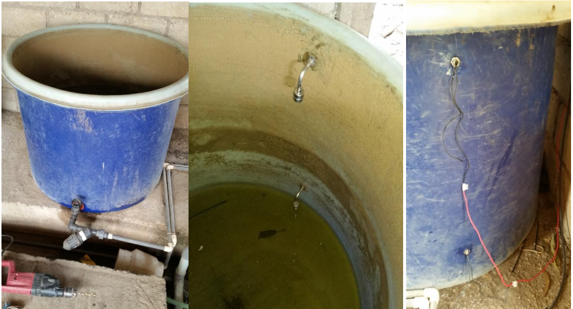
Figura 76: Sensores de nivel en tanque de fertilizante
