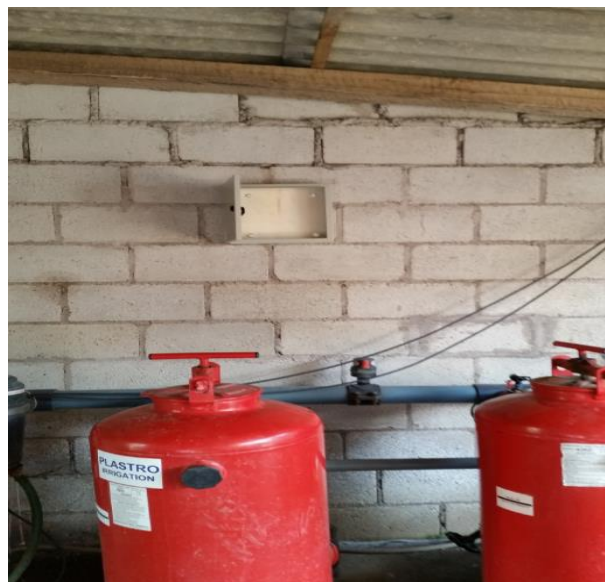
Figura 73: Caja de distribución en el cuarto de bombas
