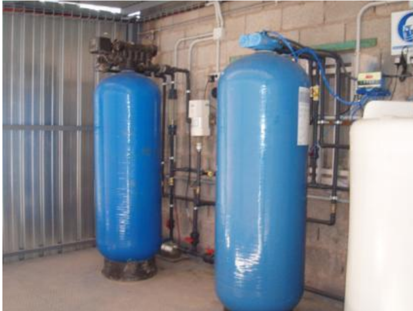
Figura 4.40 Tanques de intercambio iónico
