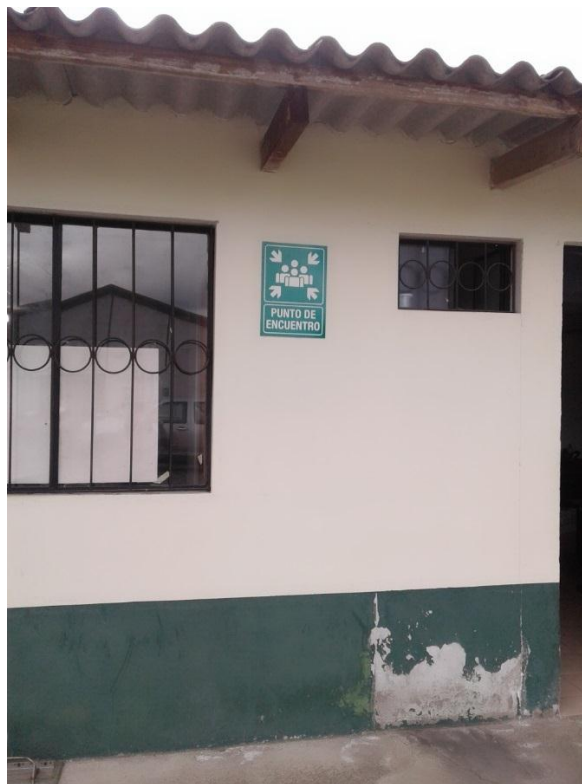
Señalética de seguridad: Punto de encuentro en el garaje
