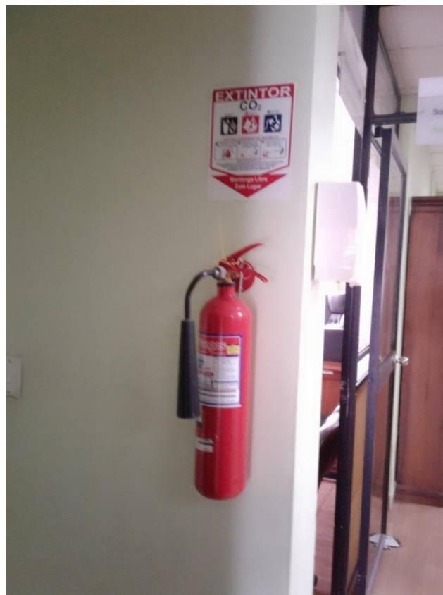
Pasillos – Extintor con indicaciones
