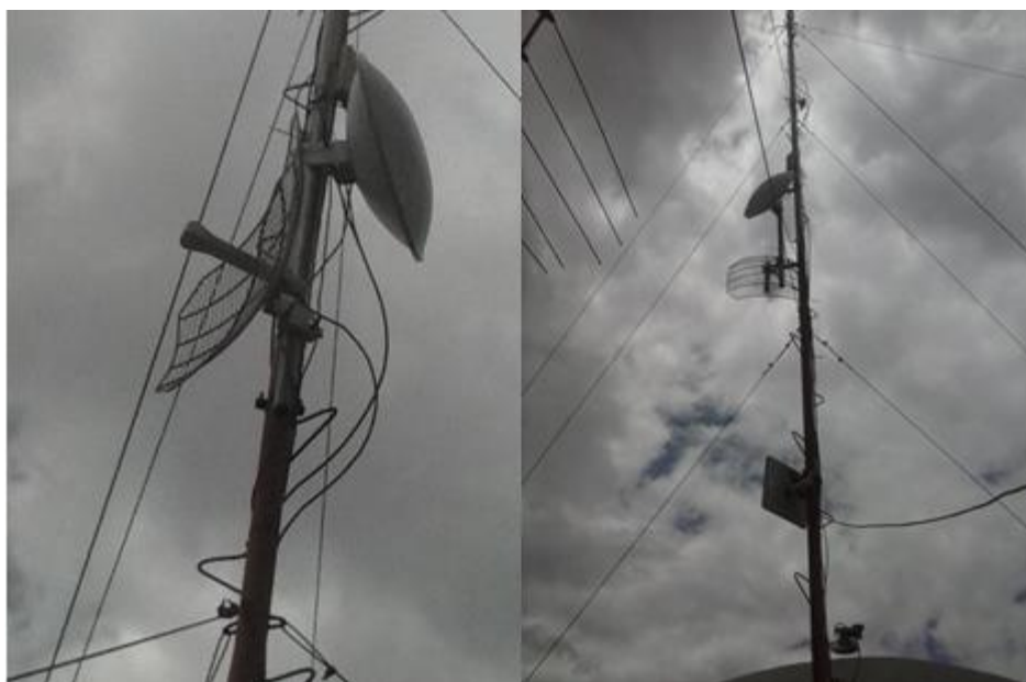
Figura 67 Equipo de distribución
