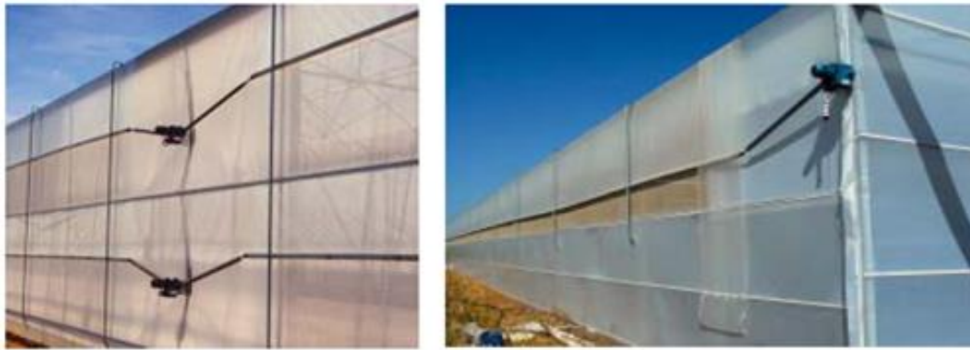
Figura 2.3 Banda lateral con motor-reductores y brazos telescópicos (De Gier).
