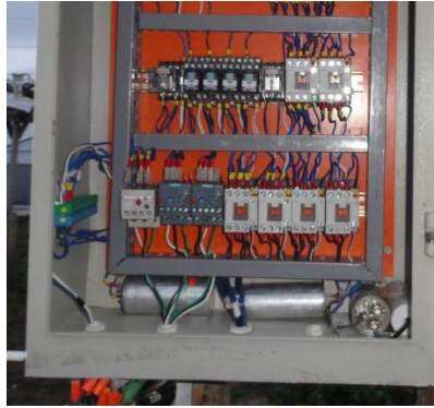
Figura 3.36 Instalaciones los elementos de potencia
