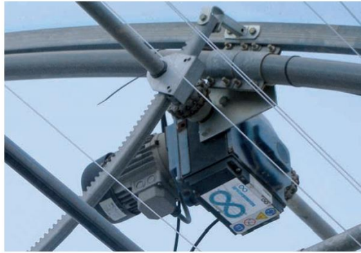
Figura 1.11 Accionamiento mecánico aplicando Motor-reductor en ventilación cenital.
