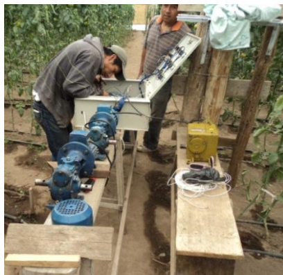
Figura 4.1 Comprobación de del sistema de control sin carga.
