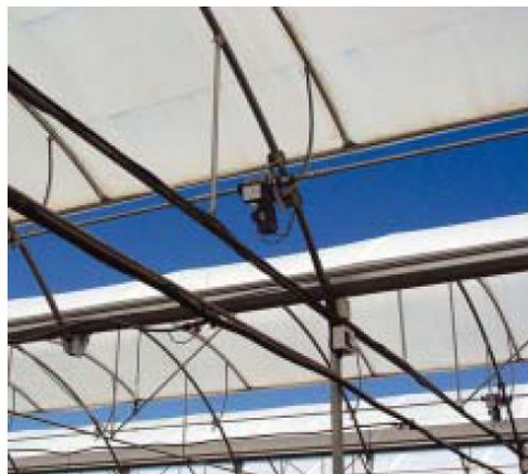
Figura 1.12 Ventilación automática con motor-reductor GW30 (De Gier)
