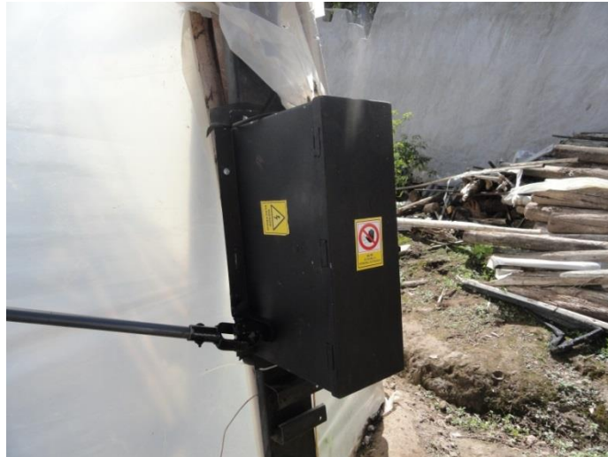
Figura 4.16 Caja metálica de protección del motor-reductor
