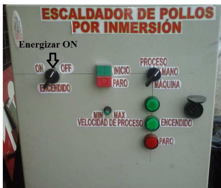
Figura 128.- Selector para energizar la máquina.
