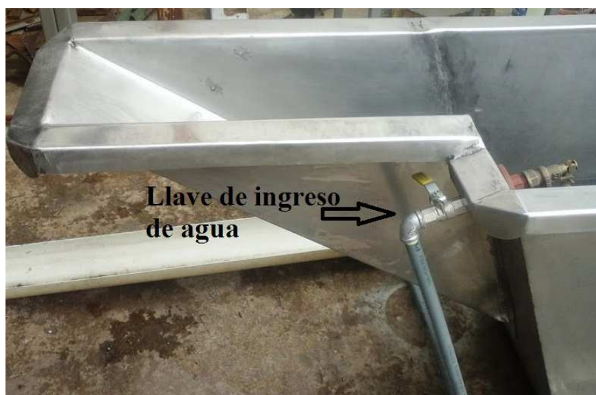
Figura 126.- Llave de ingreso de agua a la tina.
