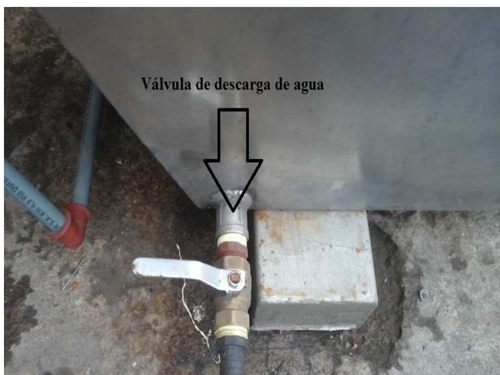
Figura 135.- Válvula de descarga de agua para la limpieza después de cada jornada de trabajo.
