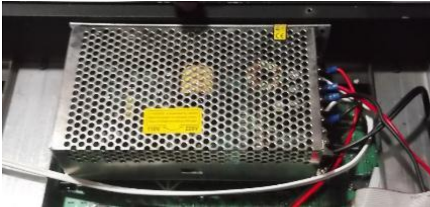
Figura 28. Fuente de voltaje S-200-5 Fuente. Los autores, 2015
