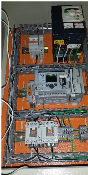
Fig. 6. Cableado del módulo didáctico.
