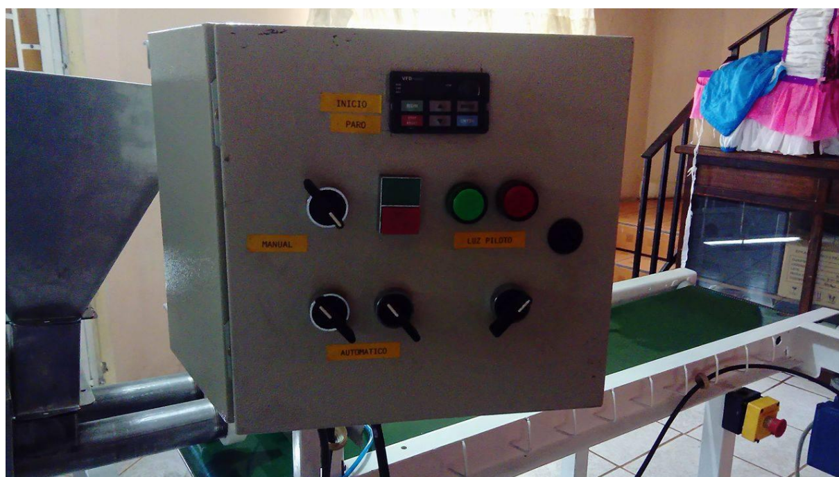
FIGURA 69 Tablero de control
