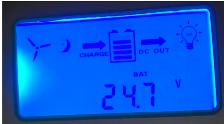
Figura 4.21. Estado de la batería sin encender el neblinero led
