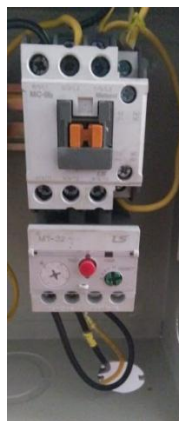
Figura 12. Contactor y relé térmico.
