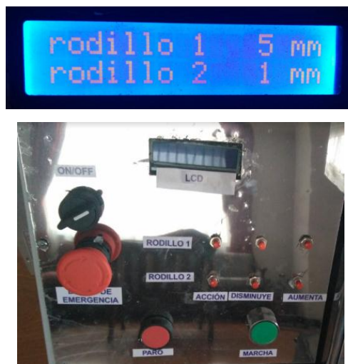
Figura 11. Panel de control.
