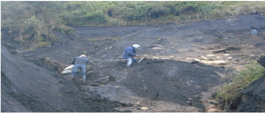
Figura 4.8 Deslizamiento en línea de conducción
