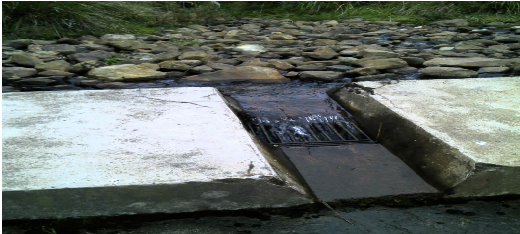
Figura 2.2 Rejilla sumergida de captación de la comunidad de Pijal
