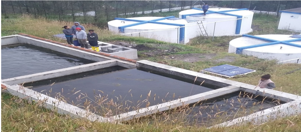
Figura 2.3 Planta de tratamiento de agua de la Comunidad Pijal
