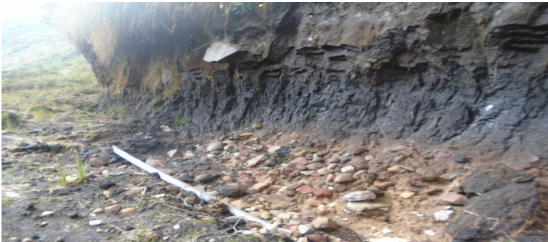
Figura 4.6 Tubería de conducción descubierta
