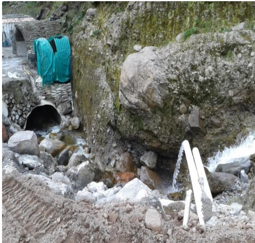
Figura 16. Contaminación con escombros
