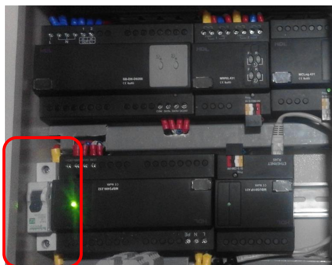
Figura 160: Breaker del gabinete Fuente: Autor
