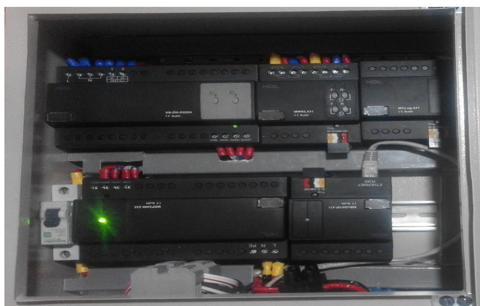
Figura 92: Montaje de gabinete de equipos HDL Buspro Fuente: Autor
