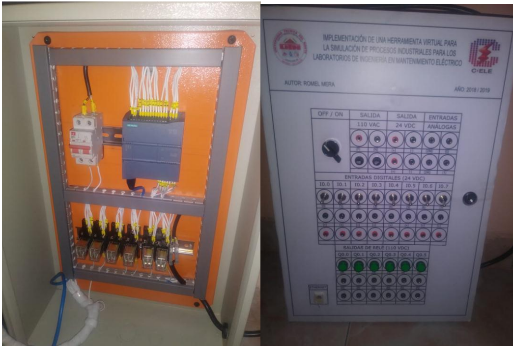
Figura 3.4 Tablero eléctrico implementado
