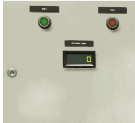
Figura A6.2 Tablero de control
