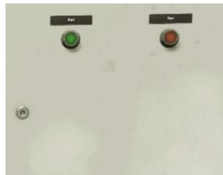
Figura A5.2 Tablero de control
