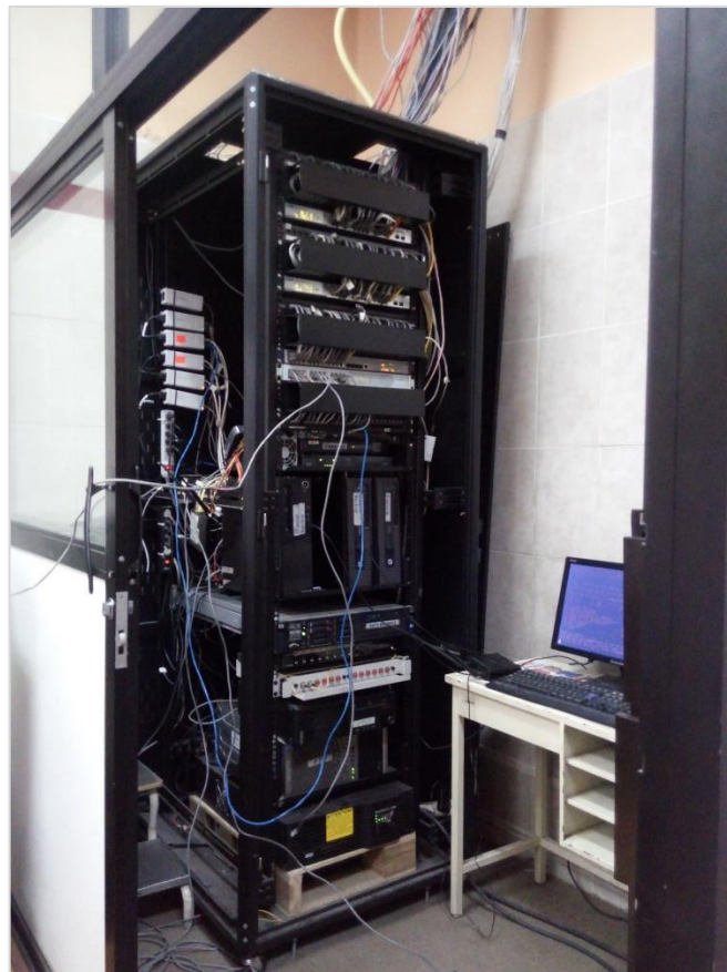
Figura 12. Cuarto de equipos
