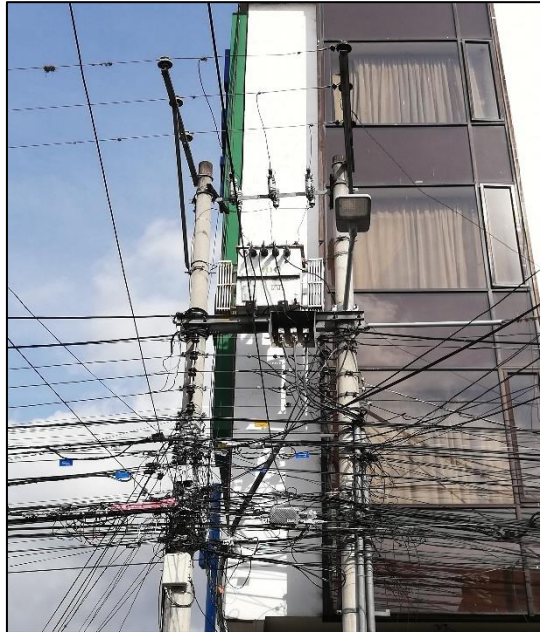
Fig. 12. Centro de transformación convencional. Fuente: Autor
