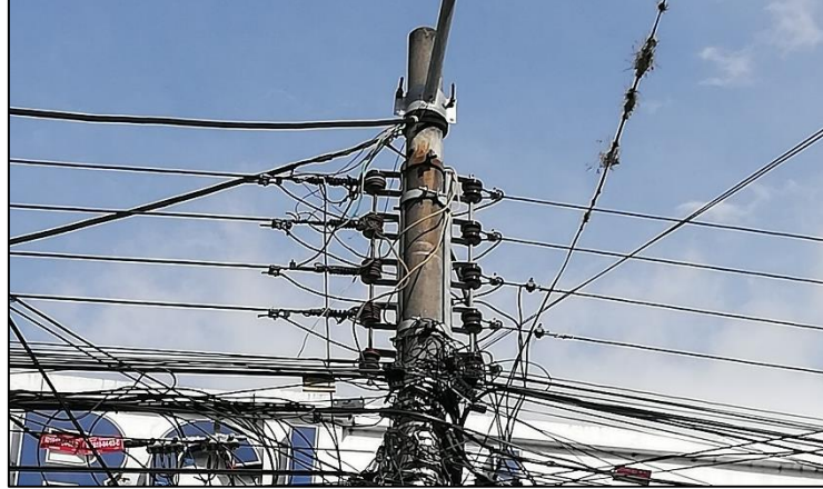
Fig. 13. Red de bajo voltaje. Fuente: Autor
