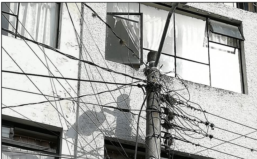
Fig. 14. Acometidas aéreas. Fuente: Autor
