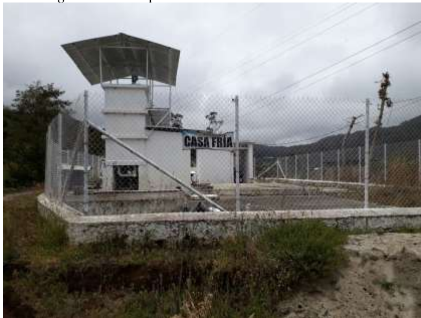
Figura 56 Planta de tratamiento Casa fría
