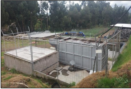
Fotografía 7. Sistema de tratamiento de aguas residuales
