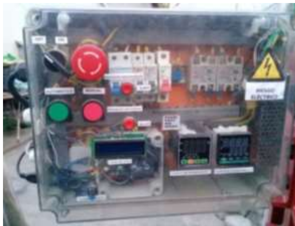
Figura 2.42. Tablero de control
